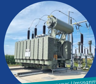
In Betrieb genommenes Umspannwerk mit neuem Transformator
