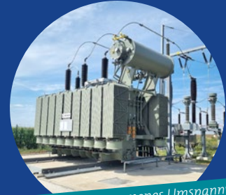
In Betrieb genommenes Umspannwerk mit neuem Transformator
